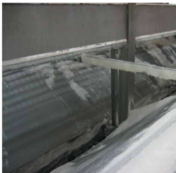
Bilde 6: Oppsamler under ristene
