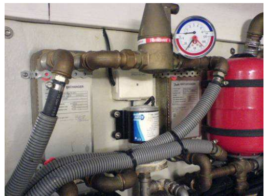
Bilde 5: Varmegjenvinningsanlegg i deltakerfartøy
