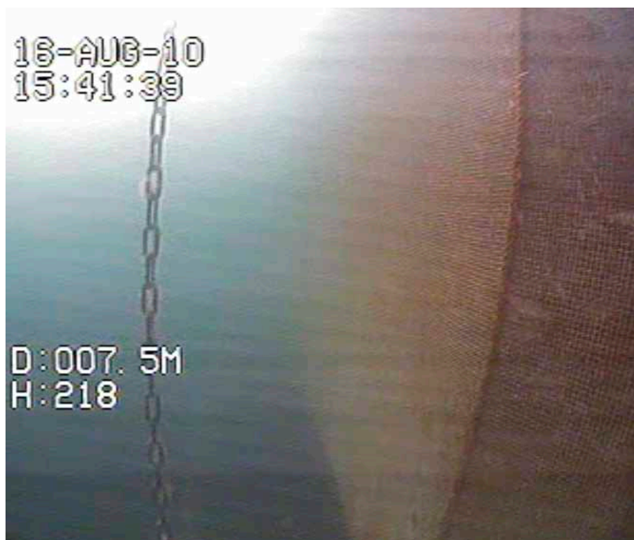
Notvegg deformert bort fra bunnkjetting.
