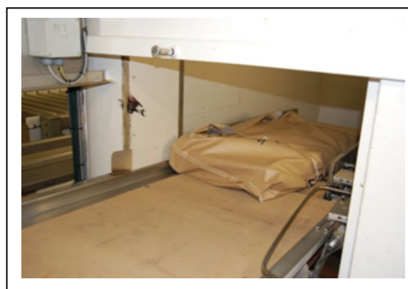
Bilde 5 Heis til fryserom
