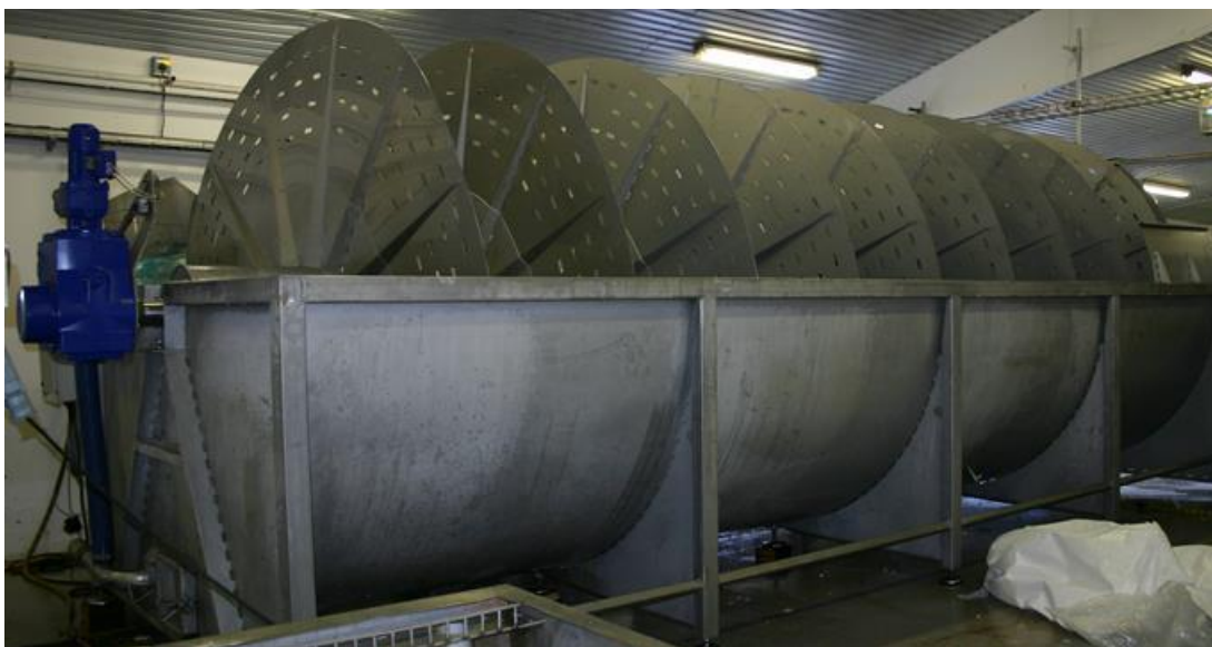
Figur 2.1. Helix laketank installert på O. Skarsbø.
