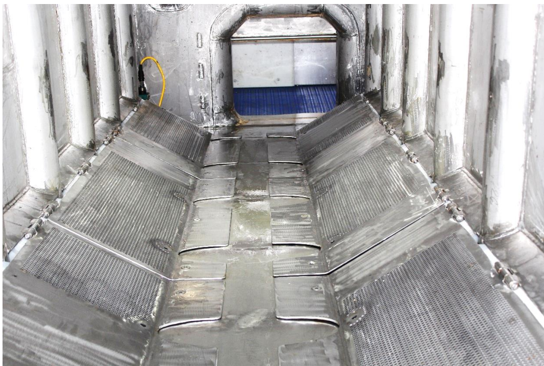
Bilde 3 Inntakstank nr. 4 med skrå bunn. Vannforsyningen i tanken kommer opp på undersiden av den perforerte bunnen ut mot sidene av tanken, med cirka 50 cm avstand. Bunnplatene er hengslet ute i sidene og kan slås opp ved behov.
