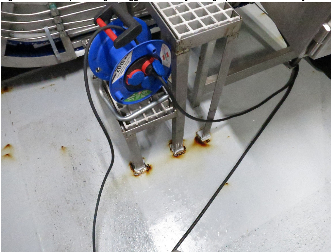
Figur 4-5 Korrosjonsangrep i karbonståldekket rundt doblingsplater under støtteben
