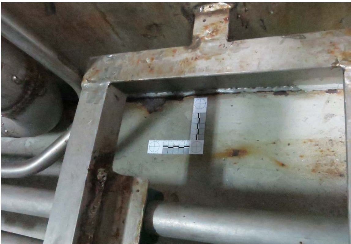
Figur 4-11 Nærbilde av korrosjonsskader på karbonståldekk i overgang skott i rustfritt og dekk i karbonstål
