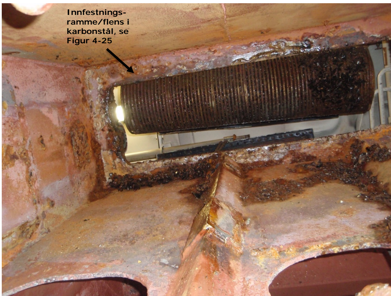
Figur 4-23 Bokskjøler sett nedenfra inne sjøkisten. Flens/innfestingsramme er indikert med pil.
