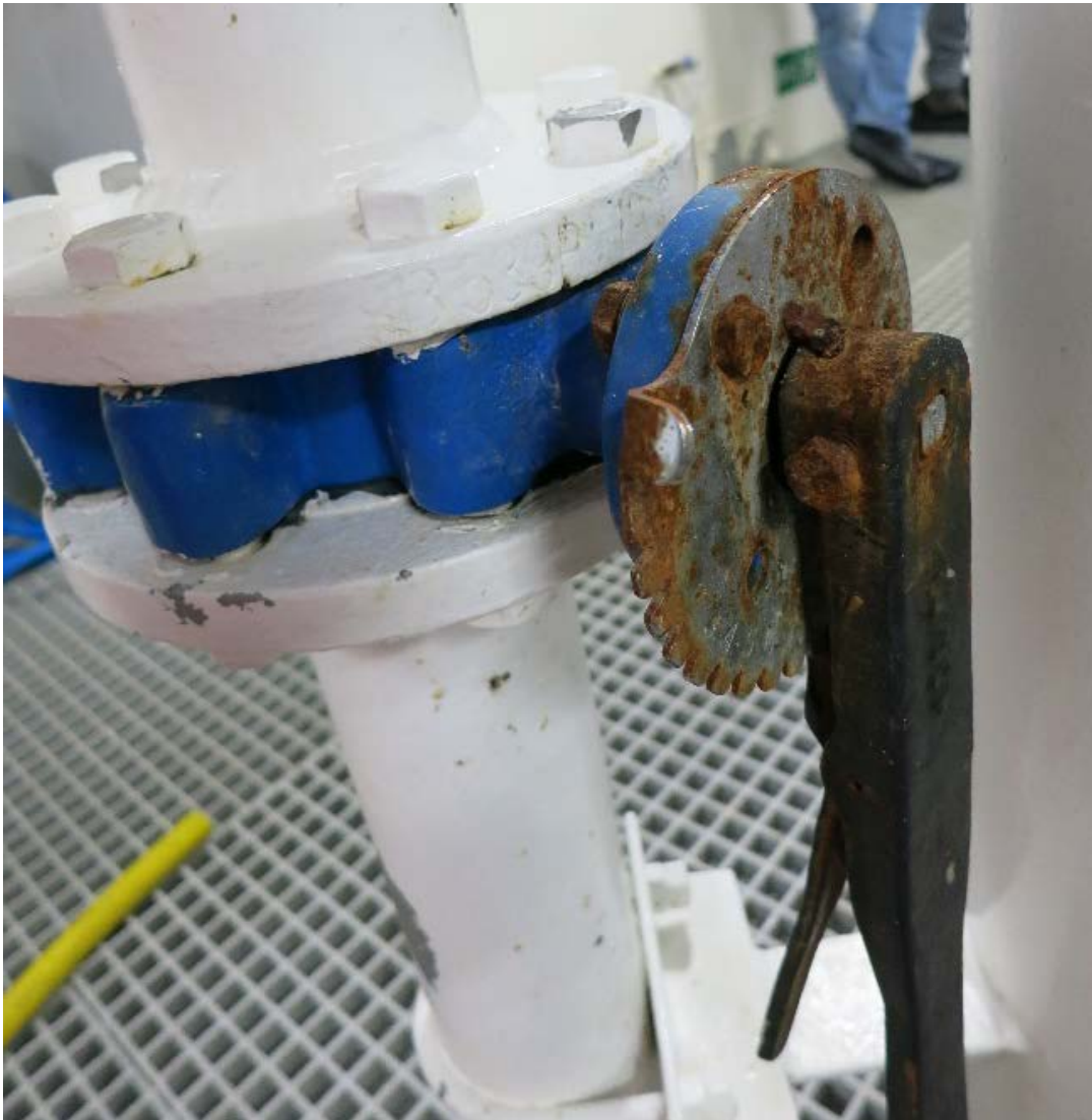
Figur 4-14 Korrosjon av bolteforbindelse på en ventil på et sjøvannsrør. Materialene er ukjent.
