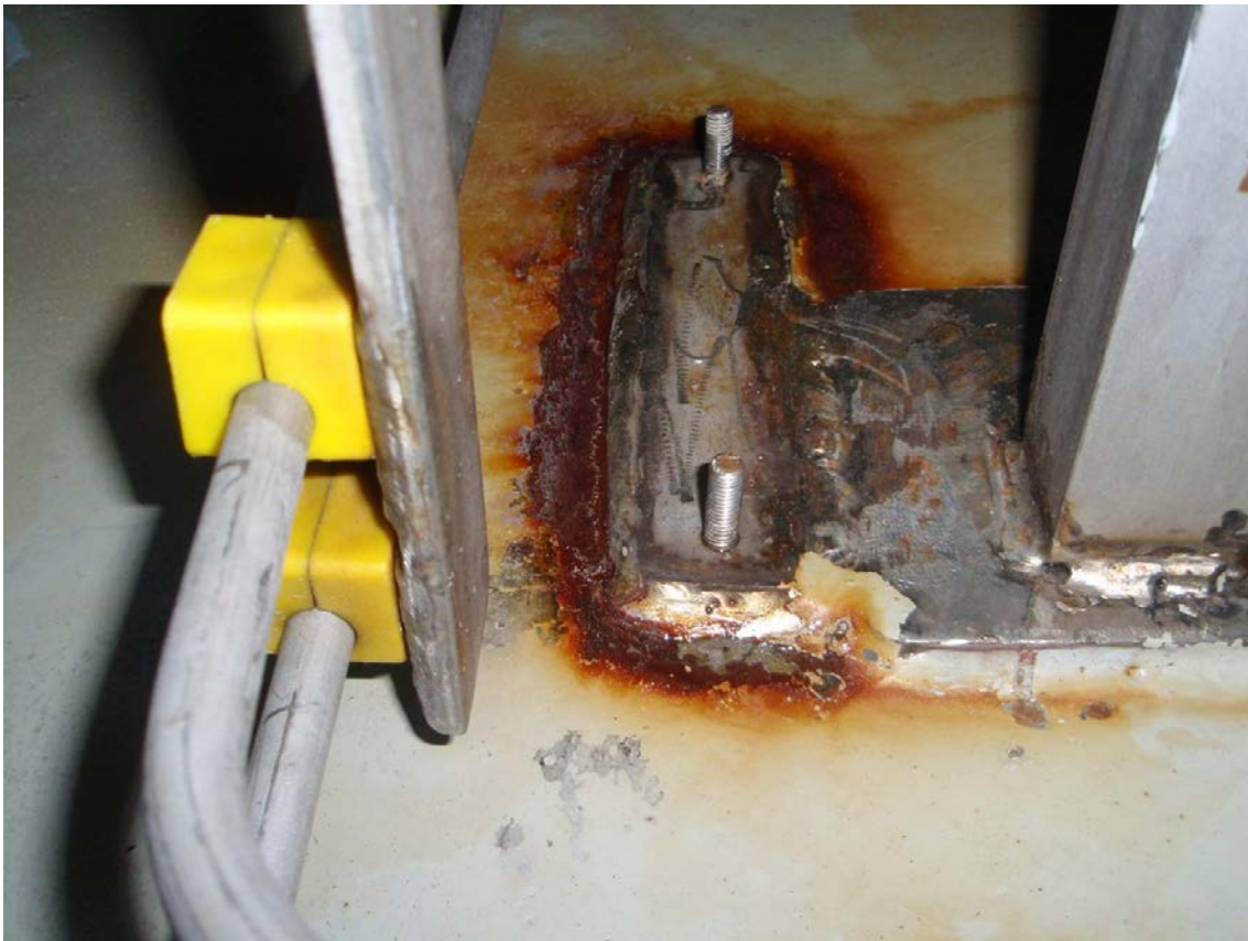
Figur 4-6 Korrosjonsangrep rundt doblingsplate
