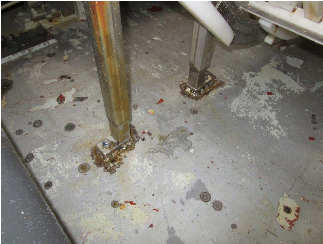
Figur 4-7 Støtteben og doblingsplater i rustfritt stål sveist på karbonståldekk. Sveisene har hulrom og er av varierende kvalitet.
