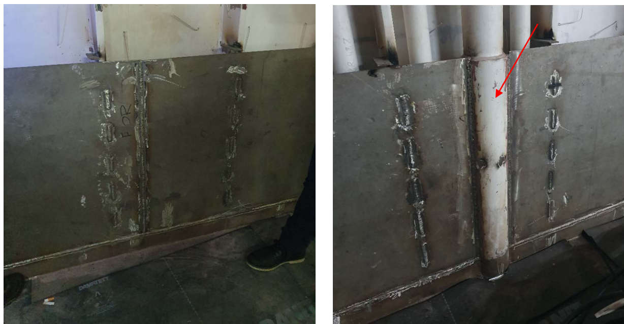
Figur 17. Langs skutesida er det rustfrie dekket på nye Geir forlenget med en omtrent 1 m brystning for å unngå galvanisk kontakt med karbonstålet i skutesida. Et rør (→) som går opp langs skutesiden midt i brystningen kan utsettes for galvanisk
