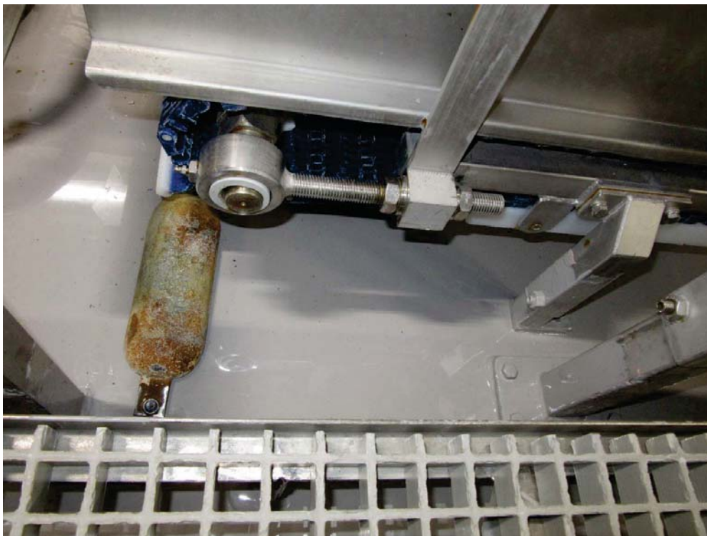
Figur 28. Anode er påmontert dekk. Siden anoden ikke er fullstendig neddykket, kan rekkevidden til anoden være begrenset på grunn av en tynn vannfilm
